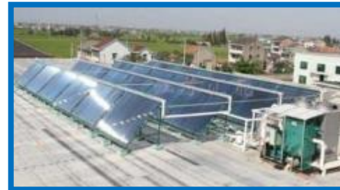
Solar Cooling Napkollektoros hűtés
